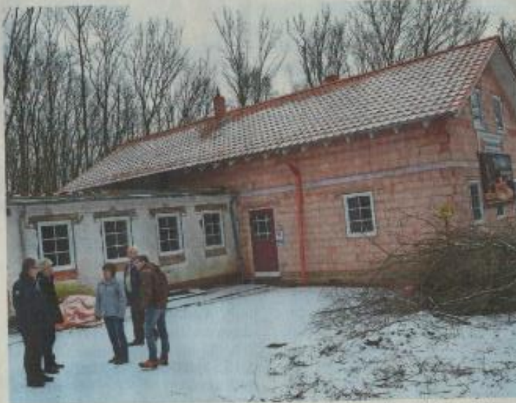
Allmählich entsteht das neue Gebäude – die Diekholzener brauchen jedoch noch professionelle Unterstützung für das Projekt.
